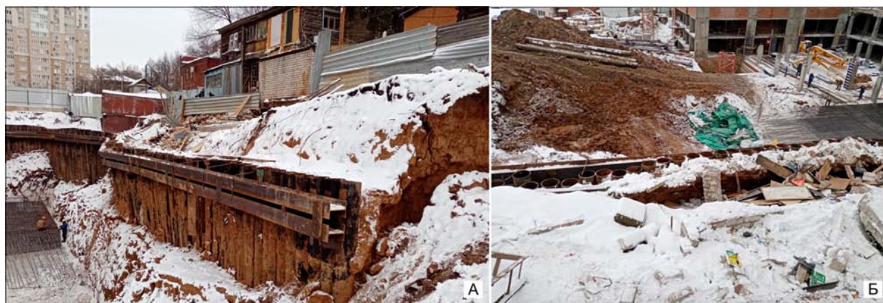
Рис. 6. Оползень в северо-восточном борту котлована, строящегося дома на ул. Коммунистической рядом с д. 106 Условные обозначения: А – общий вид с подпорной стенкой, Б – вид сверху на линию отрыва вдоль подпорной стенки. Дата образования 03.12.2019. Фото А. И. Смирнова.
